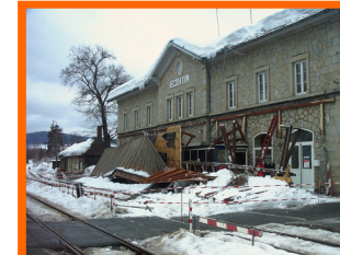
Einsturz eines Bahnsteigvor-daches nach Abgang einer Dachlaine 2006 in Zwiiesel (Dtl.)
