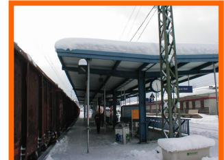
Sperung des Bahnsteig-daches, die Längsträger d. Bstg-daches haben sich durchgebogen 2006 Bhf Traunstein
